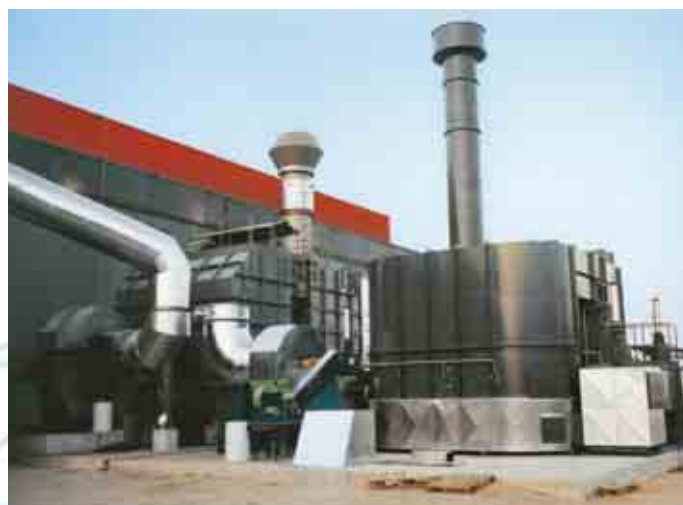
Obróbka powierzchniowa metalu • Bliźniacze dopalacze regeneracyjne z przepływem gazów 45.000 \text{Nm}^3/\text{h} zainstalowane w różnym okresie czasu
