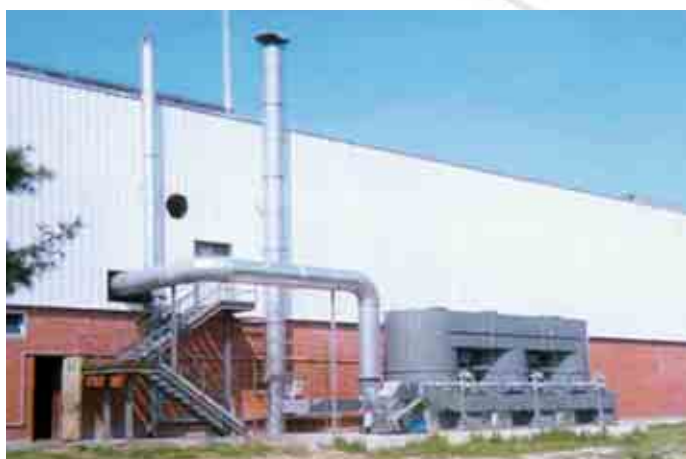
Obróbka metalu • 12.000 Nm 3 /h
